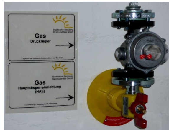
Bild 2: Hauptabsperreinrichtung mit Druckregler im Keller
